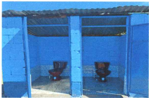
Foto 1: Sanitario deteriorado y quebrado
