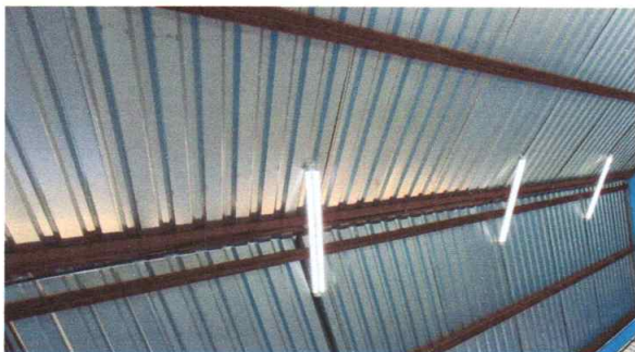
Foto 3: Sistema eléctrico instalado
